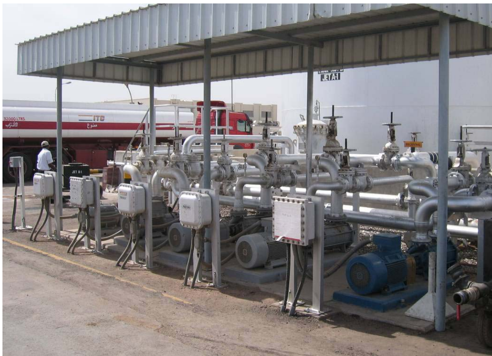
estación de bombeo de combustible de aviación existente
